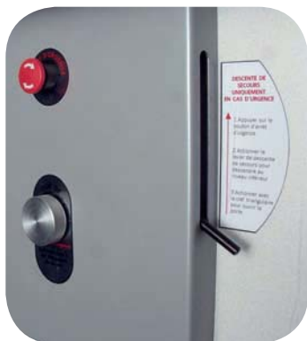
Commande de descente de secours en cabine
